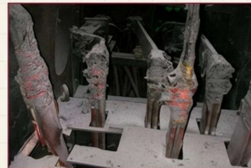
熱損害特寫：銅排與絕緣
