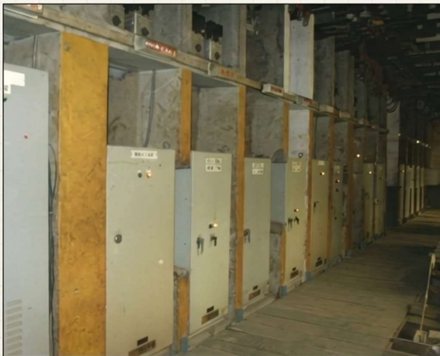
一變開關室 - 宏觀現場
