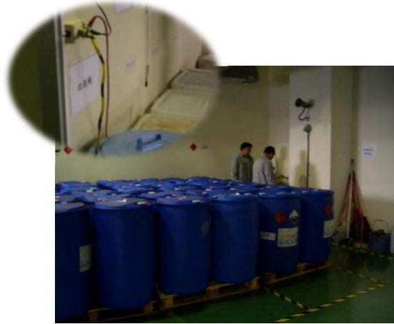
室內溶劑儲存(無強制通風環境)未劃分防爆區域，同區域內電氣使用情況
