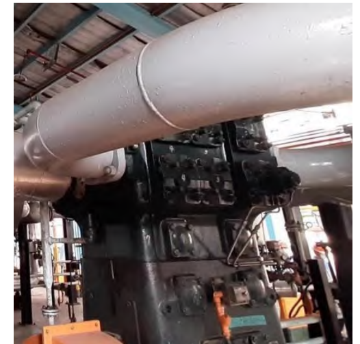
前鎮儲運所C-1304壓縮機
