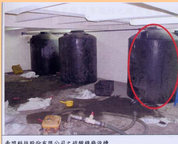
帝盟科技股份有限公司之硫酸鎳廢液槽
